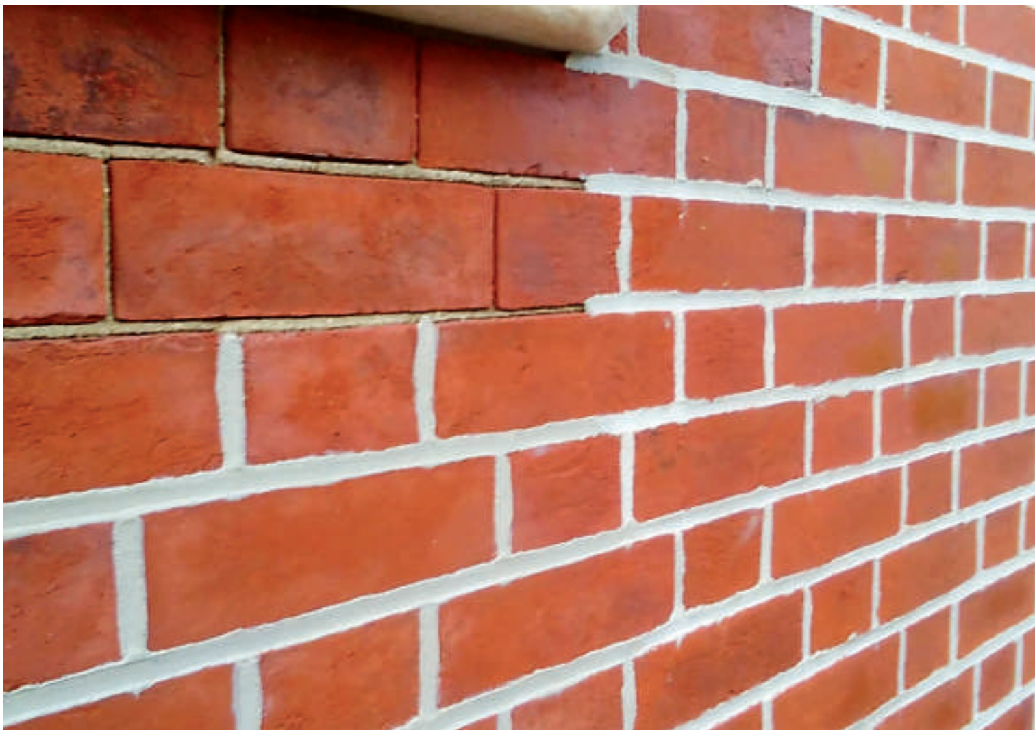
Η επιδιόρθωση των αρμών στις περισσότερες περιπτώσεις απαιτεί αφαίρεση του υφιστάμενου διαβρωμένου κονιάματος και πλήρωση με συμβατό επισκευαστικό κονίαμα.
