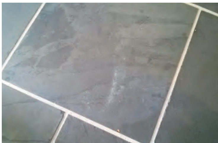
Το επισκευαστικό κονίαμα πρέπει να είναι συμβατό με το υφιστάμενο ως προς τα τεχνικά και αισθητικά χαρακτηριστικά, για να επιτευχθεί συνοχή με την κατασκευή.
