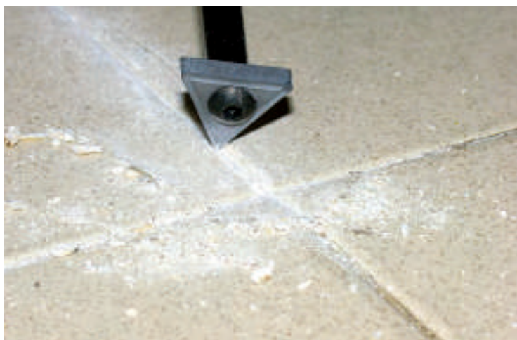
Για την αφαίρεση του κονιάματος είναι προτιμότερη η χρήση χειροκίνητων και όχι ηλεκτρικών εργαλείων, ώστε να αποφεύγεται φθορά των δομικών στοιχείων.
