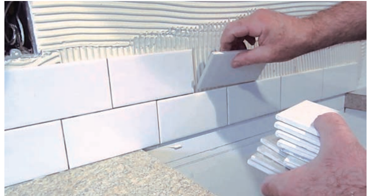
Η επίστρωση των πλακιδίων σε τοιχοποιία γίνεται από κάτω προς τα άνω για την αντιμετώπιση της κατακόρυφης ολιόθησης, η οποία δεν πρέπει να υπερβαίνει τα 0,5 mm κατά EN 1308.
